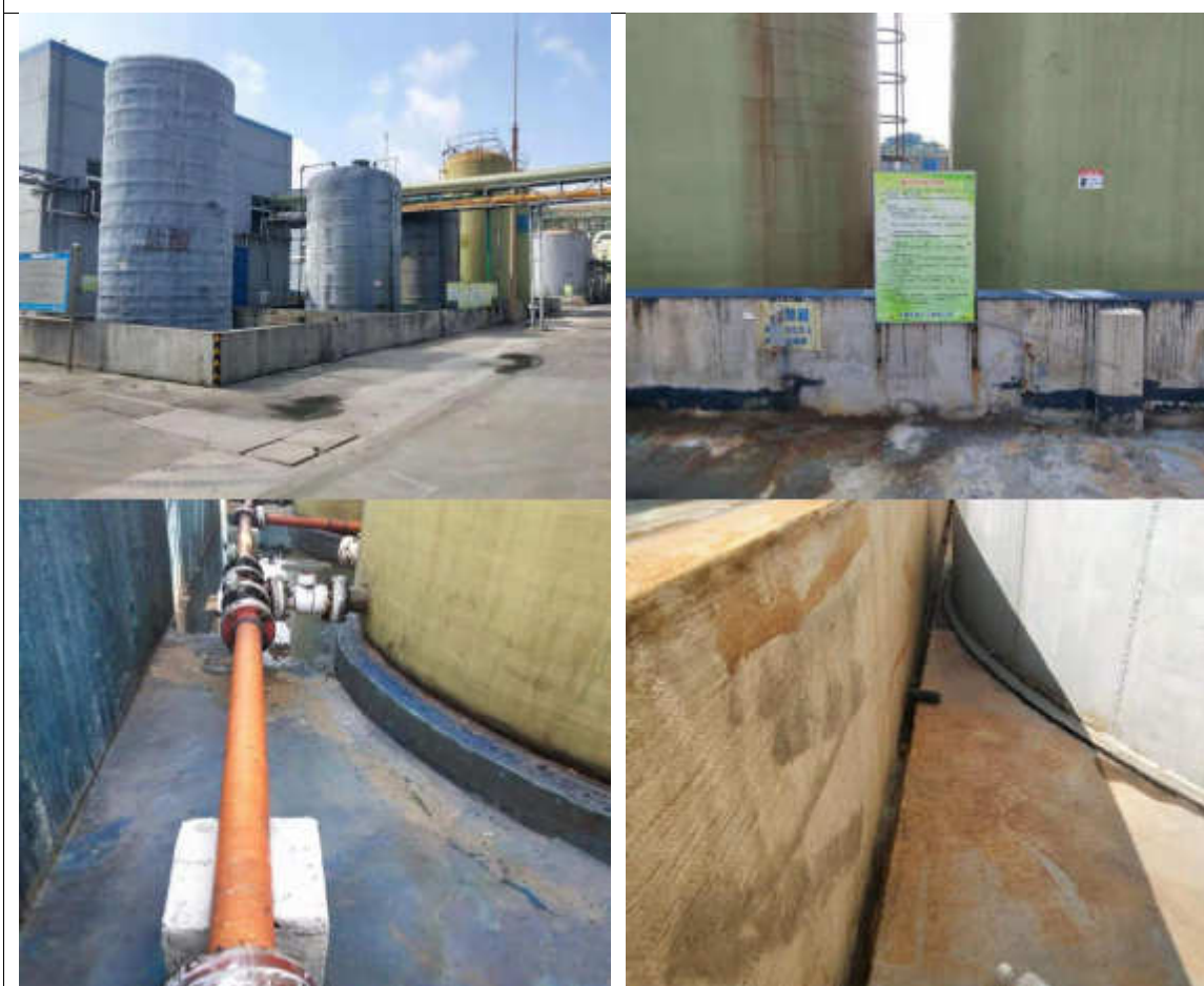
酸碱罐区：盐酸、液碱储罐区地面已做防腐防渗处理，四周设有围堰、导排沟，地面无破损。
