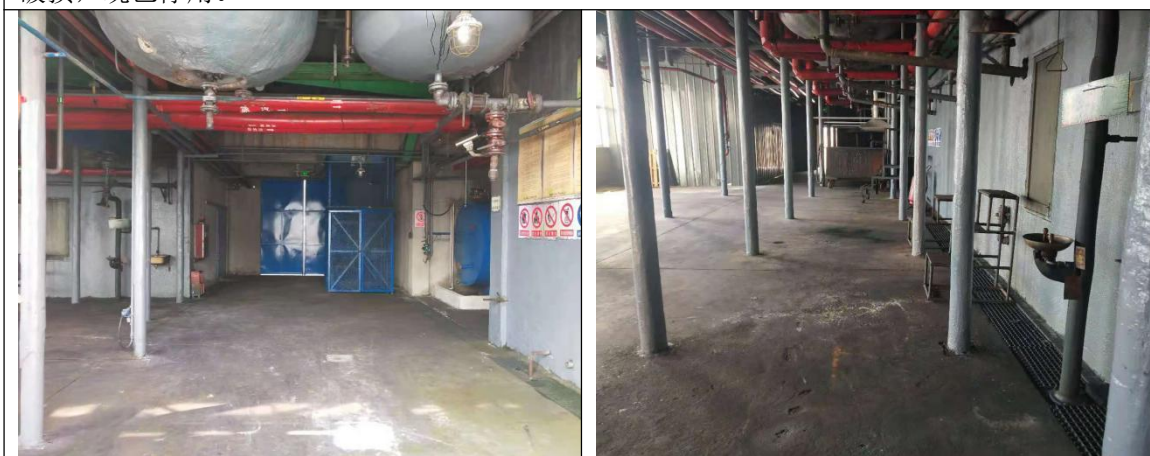
永固紫合成车间：完成烷基化，硝化，加氢，缩合闭环反应生成粗品永固紫，车间地面均已硬化，无明显裂缝。
