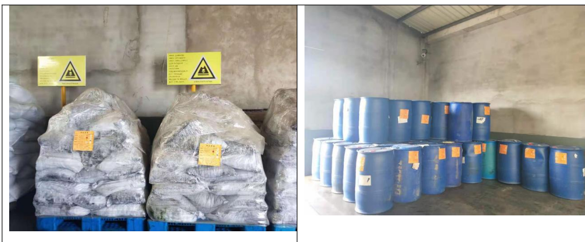
危废仓库：危险固废暂存库位于厂区西北侧，主要用于堆存水处理污泥、废活性炭等危险废物。地面已按照要求采用防腐防渗的环氧地坪，四周设有导排沟，地面无明显破损。
